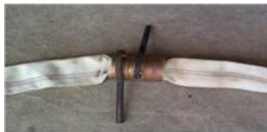
[그림 VI-49] 호스 개폐기(Spanner)를 이용한 소방호스 연결모습
