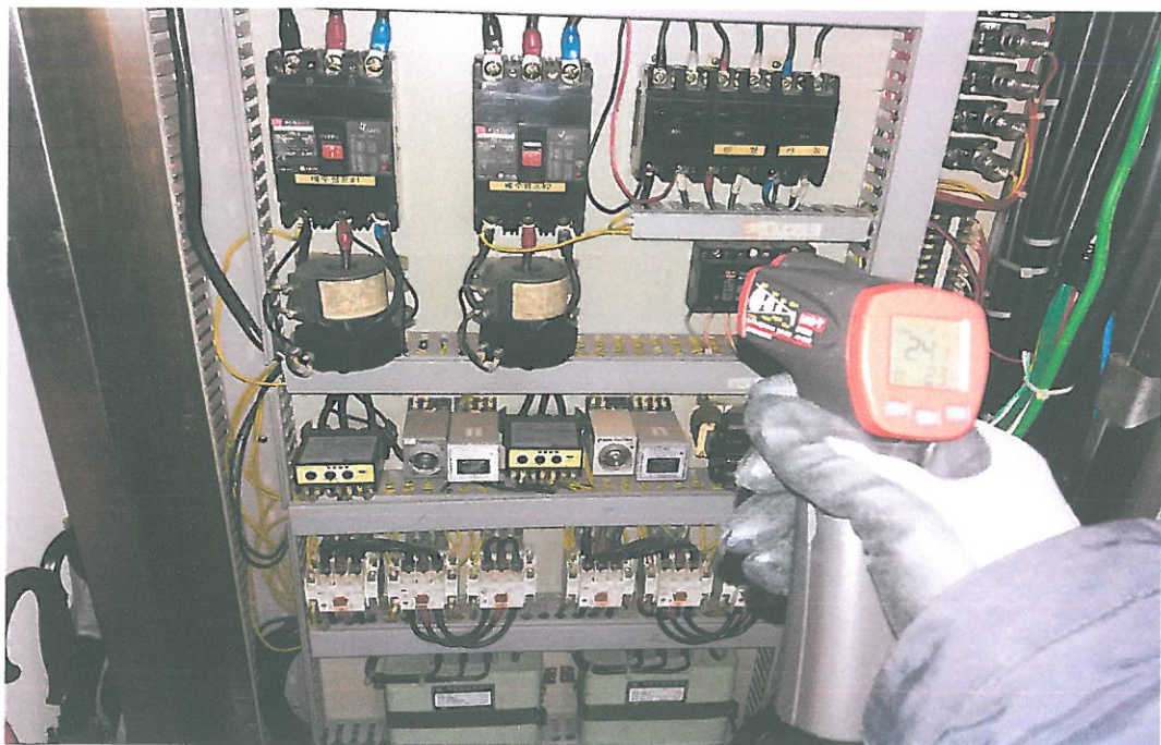
모타부하용 개폐기 발열 점검(답십리지하차도)
