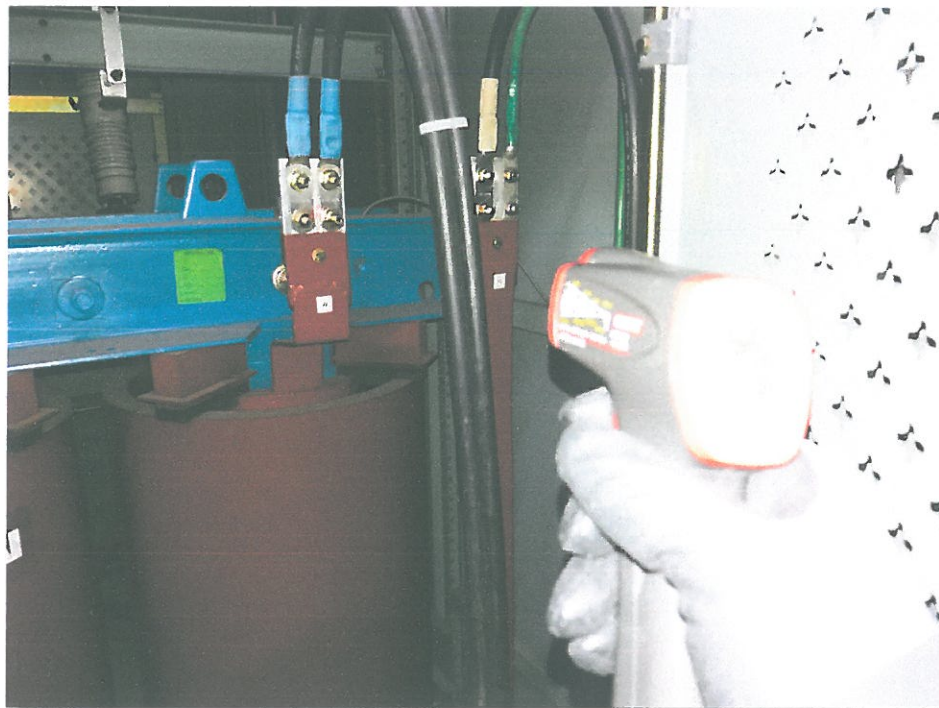
변압기 접속단자 점검(신답지하차도)
