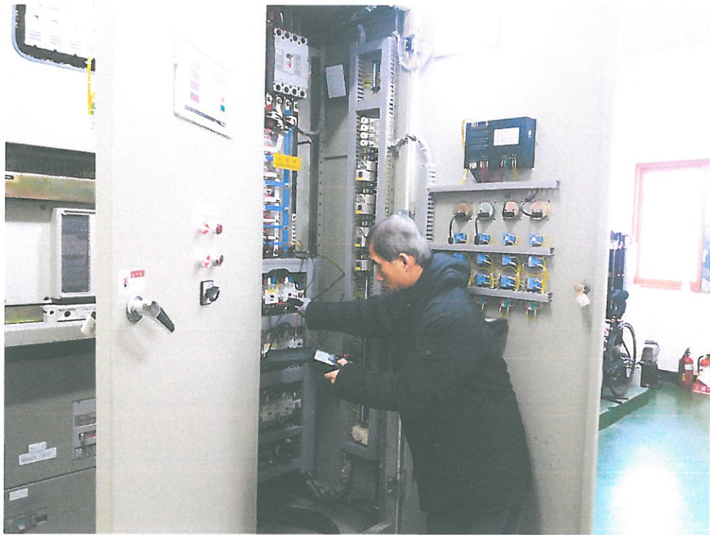
부하 절연저항 측정(마장지하차도)
