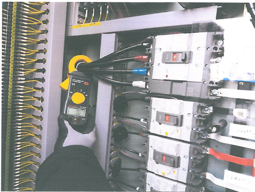
전기회로 누전여부 점검(신내지하차도)
