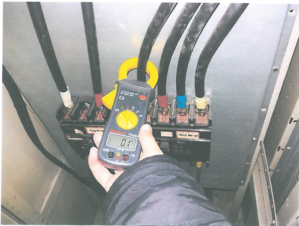
각상 전류측정 및 점검(신내지하차도)
