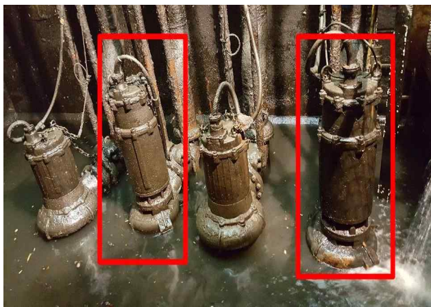
노후 배수펌프(월계1 지하차도)
