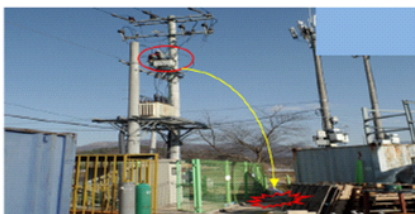
가로등 · 신호등 작업발판 미설치
