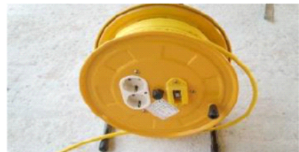
충전부 방호조치 · 누전차단기 설치
