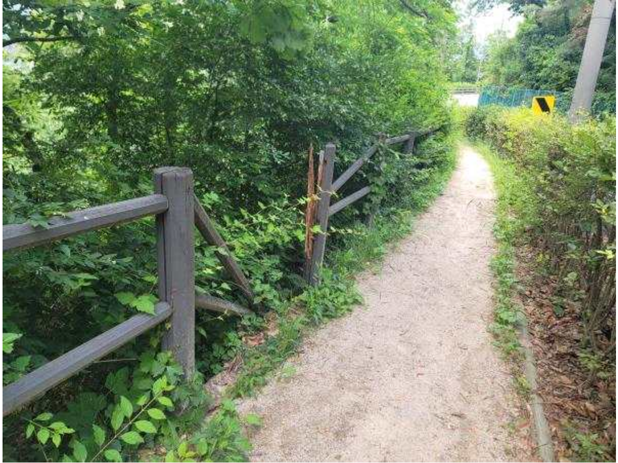
안전난간 보수 전
