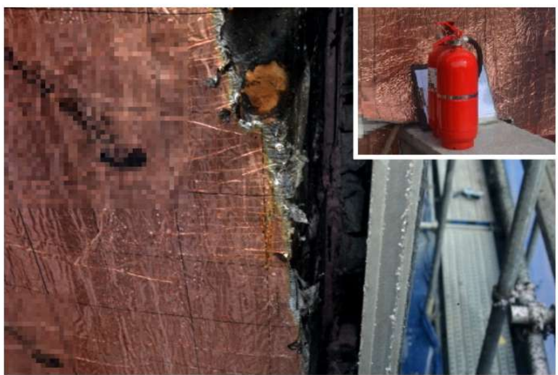
도봉구 쌍문동의 공사장에서 화재가 발생해 외벽 단열재가 일부 불에 탔으나, 관계자에 의해 소화기로 초기진화되었다.
