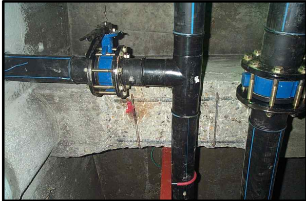
<인위적 손상-콘크리트 보 파손 및 철근노출>
