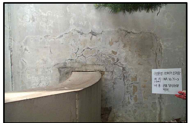
<벽체 덕트 시공부 망상균열 및 백태>
