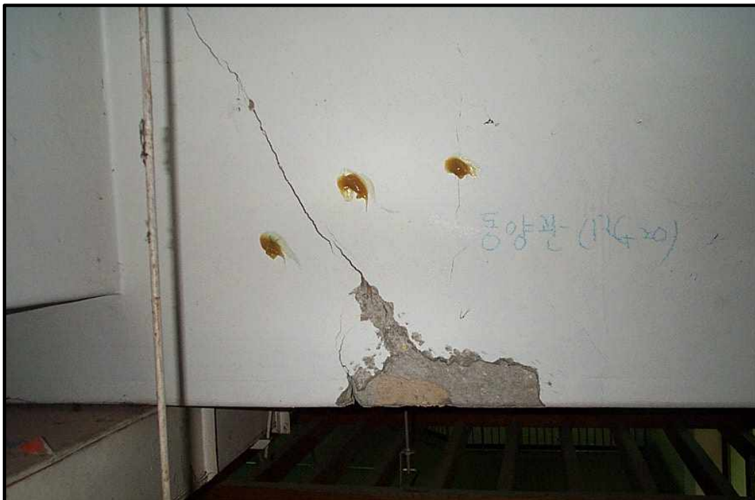
<원숭이사쪽 보(RG20)에 발생된 균열>
