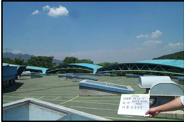
<옥상층 방수포 들뜸 및 도장탈락>
