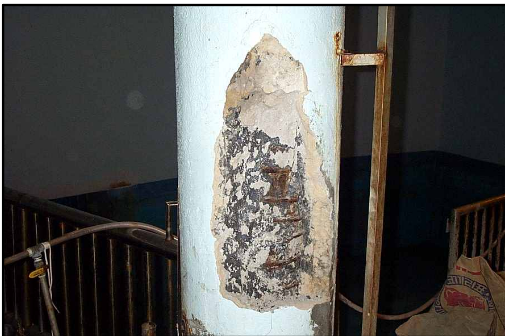
<돌고래 연습풀 기둥 철근부식 및 콘크리트 박리>
