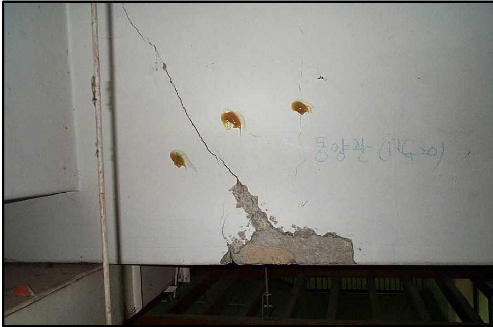
<RG20(400×900) 보의 RB12측 부위 균열>
