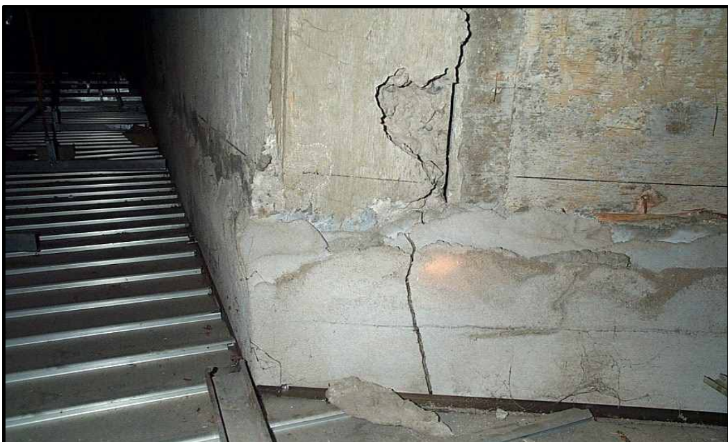
<2층 파라펫 균열부-내부>
