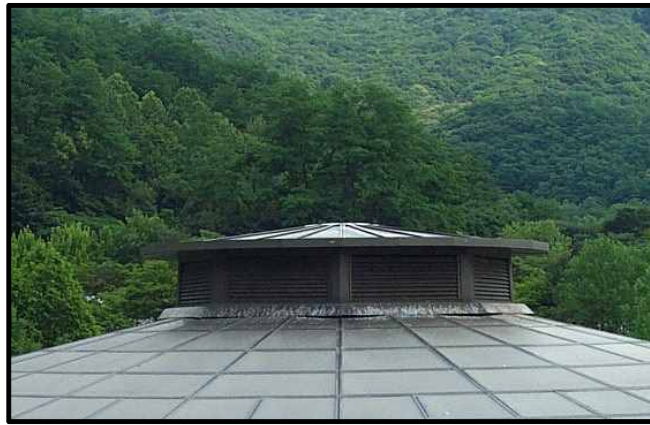
<채광창 상부 조류 분뇨에 의한 오염>
