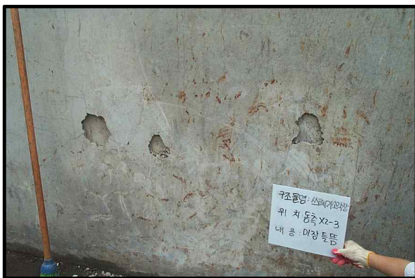
<벽체 마감 콘크리트의 들뜸 및 파손>
