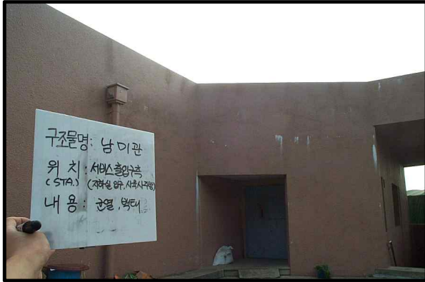
<외벽체에 발생한 균열 및 균열부 백태>
