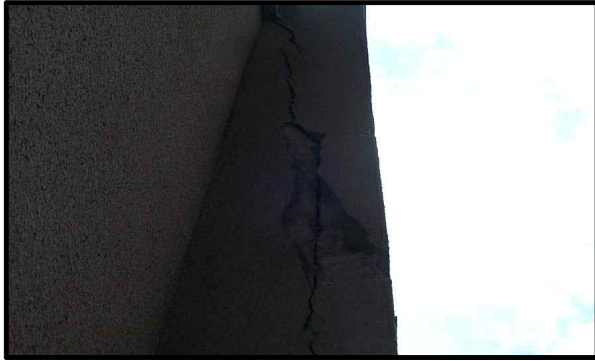
<외부계단 옹벽부 균열 및 이격>
