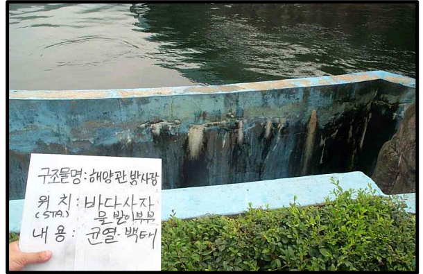
<방사장 벽체 균열 및 백태>
