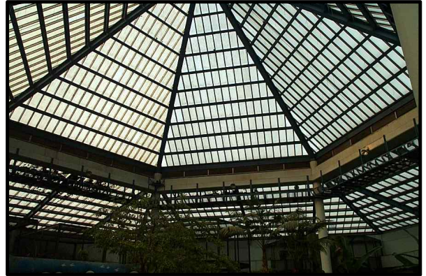
<채광창 전경-코킹부위 노후화로 누수>
