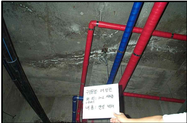
<슬래브 하부 균열 및 백태>
