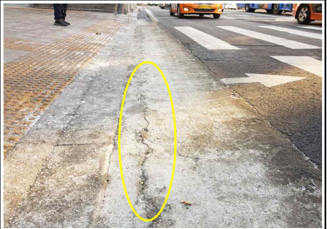
연번 14 측구시공 균열 발생(위차도 4)
