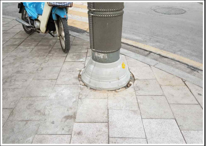
연번 38 가로등 기초 주변 정밀시공 미흡(우차도 18)
