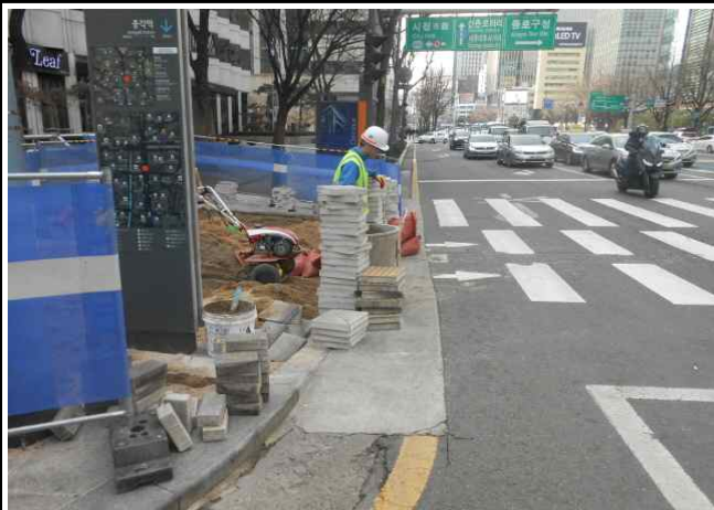
연번 39 공사 시행 중 안전펜스 설치 미흡(우차도 11)
