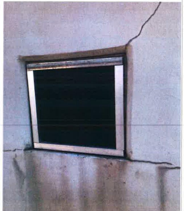
환풍구(환기구) 방충망 설치 및 손상부분 없음
