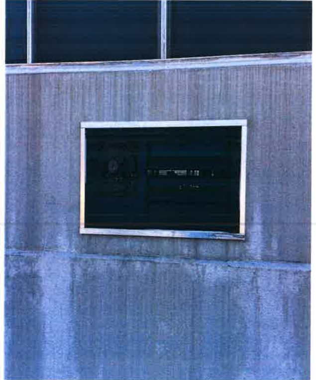
환풍구(환기구) 방충망 설치 및 손상부분 없음
