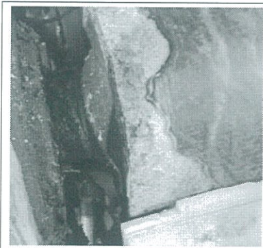
롤러 부식에 따른 표면 코팅 탈락
