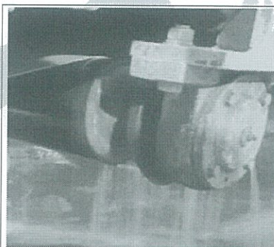
롤러 상태 양호하나, 베어링은 이상소음 발생
