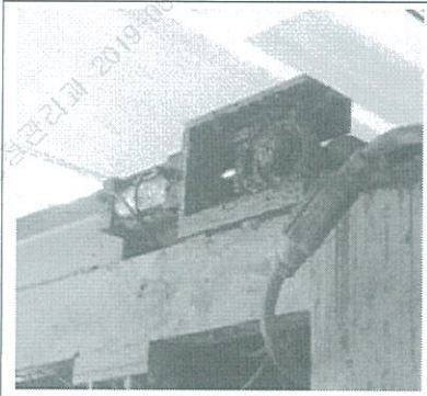
장력조정장치 베어링 파손 누유 발생
