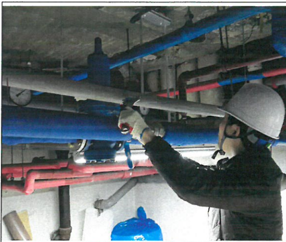
기계실 급수배관 감압변 점검
