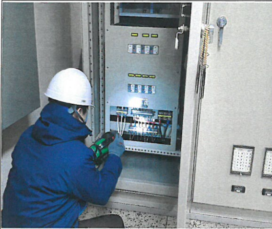
전기실 정류기 제어반 점검
