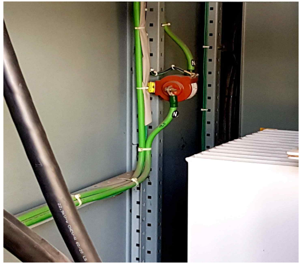
변압기 2중 접지선 ZCT 상태 확인
