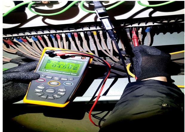
독섬벽천분수-수중펌프 절연저항 측정
