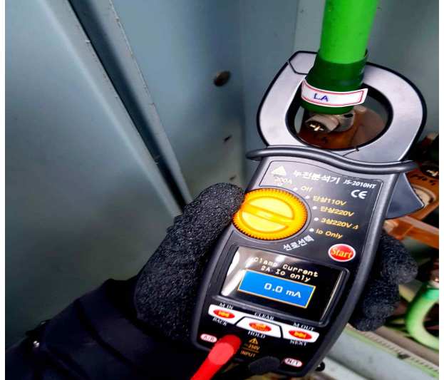
피뢰기 누설전류 측정
