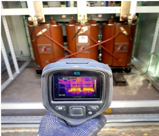
변압기 열화상 측정
