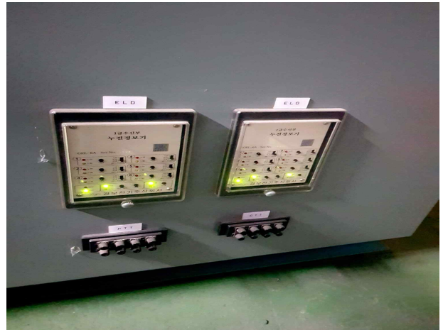
뚝섬벽천분수-누전경보기 경보상태 확인
