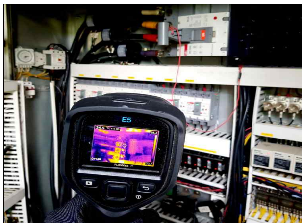
난지물놀이장-저압 MCCB 열화상 측정
