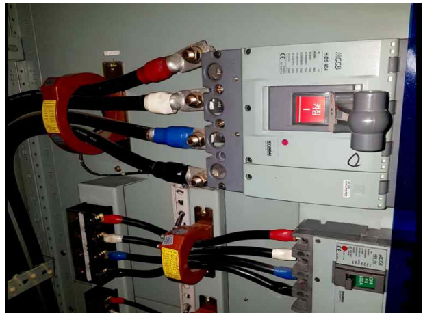
똑섬벽천분수-저압간선 MCCB 열화상태
