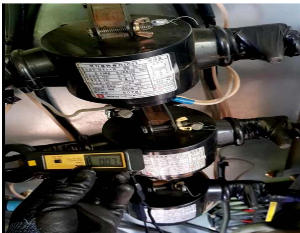
난지물놀이장- 인입 CT 상태
