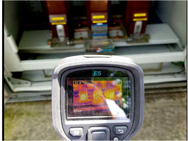
난지거울- 고압 기기 열화상 측정
