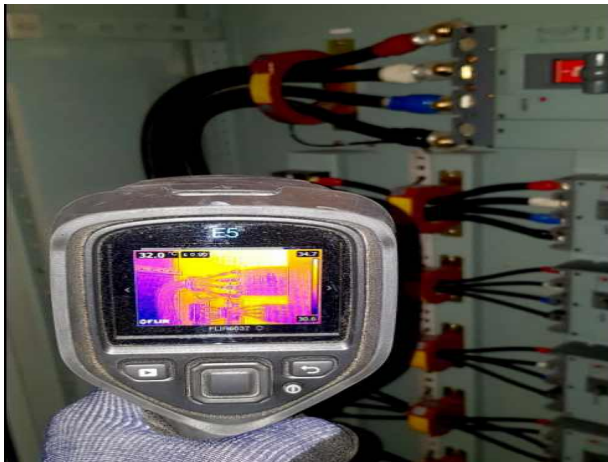
똑섬벽천분수- 저압 MCCB 열화상 측정
