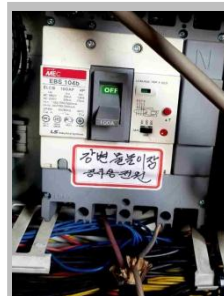
공사용전원 MCCB 차단기 OFF
