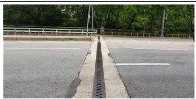
연번 4 : 영동5교(A1,A2,A3,A4) 후타재 파손-단일공사로 정비
