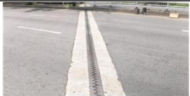
연번2 : 영동2교(A3,A4) 후타재 균열.마모-단일공사로 정비
