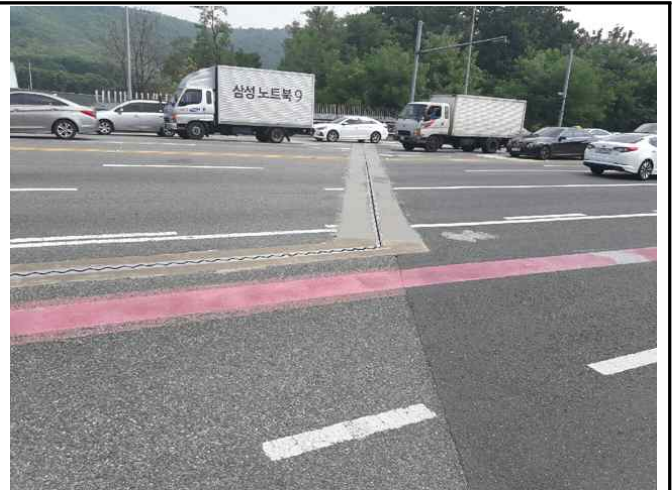
연번: 현릉교 신축이음장치(A2, 핑거조인트)
