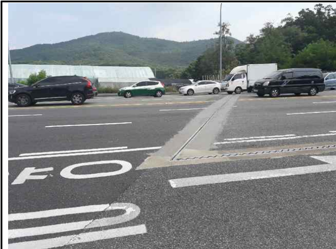
연번: 현릉교 신축이음장치(A1, 핑거조인트)
