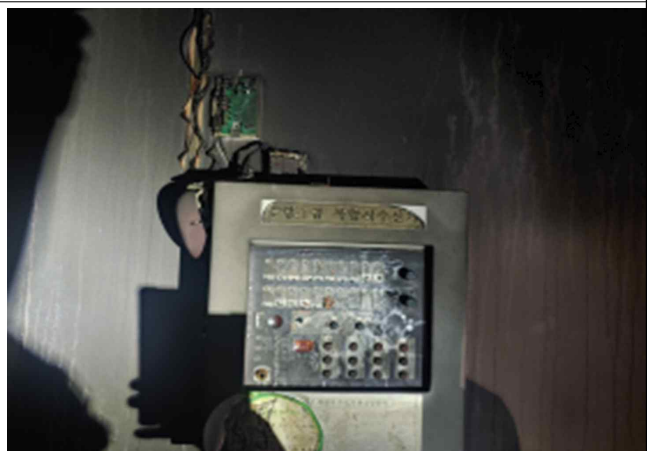
1층 수신기(전기배선 화재로 작동불)
