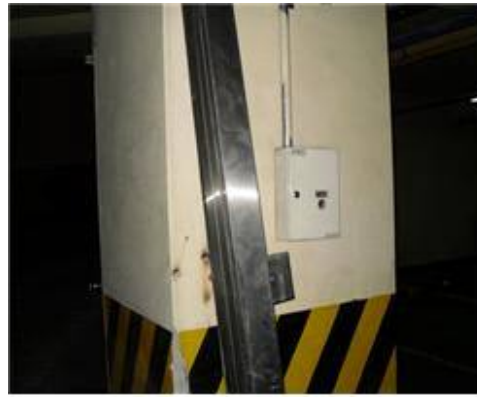
▲ 방화셔터 레일이 파손된 상태로 방치한 경우
