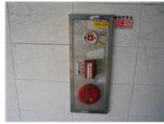
▲ 위치표시등의 파손을 방지한 경우
