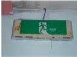
▲ 유도등이 부식되어 점등되지 않는 경우
