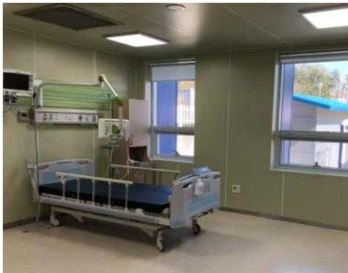
그림 20 배기구 설치 사례(천정 배기)
