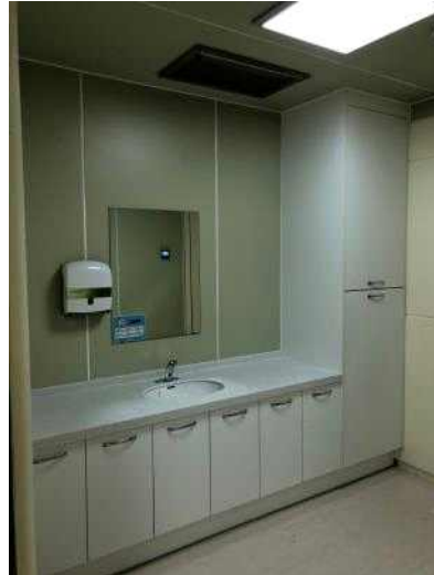
그림 30 병실전실 수납 및 손씻기 시설 설치 사례
