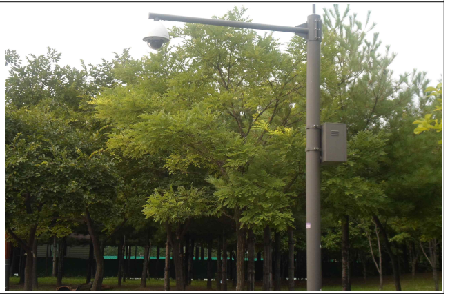
○ 노후 CCTV 교체
