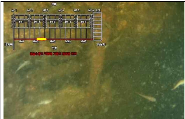
가동보 상류 MW2-4 철근노출
