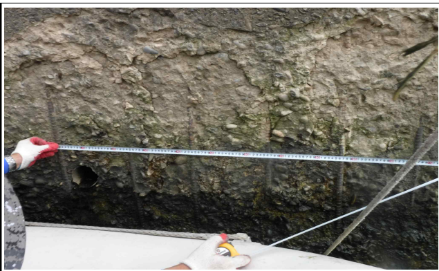
우안옹벽 STA.110m 철근노출
