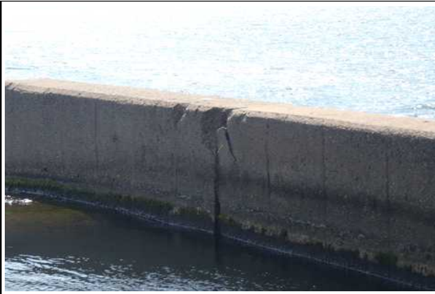
중앙어도 우측벽체 좌측면 파손
