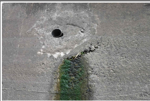
좌안옹벽 STA.095m 누수
