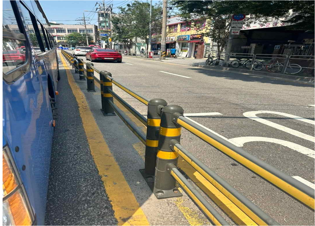
내 용 무단횡단금지시설 파손 임시조치(철거, 2차사고 예방)
