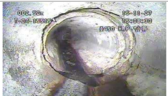
이음부에 균열 또는 쪼개짐 발생
