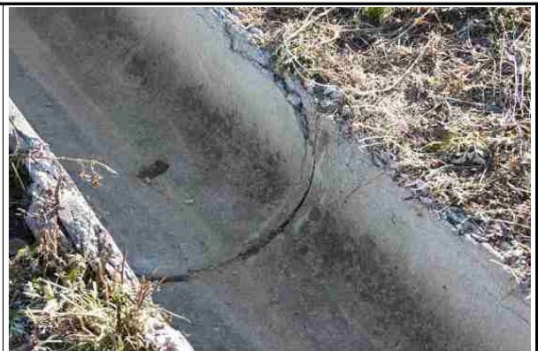
배수로-파손 및 열화
