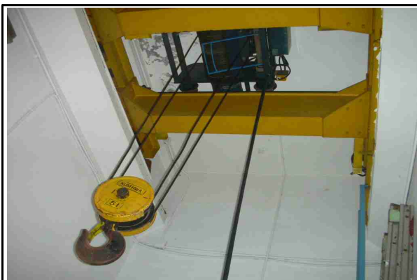
권양기 - 작동상태 양호
