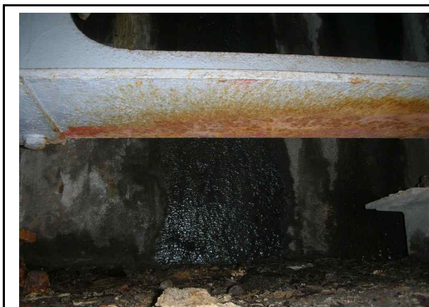
·위 치 : 주형 및 가로보(Steel Plate Girder) ·현 황 : 녹발생 ·대 책 : 재도장
