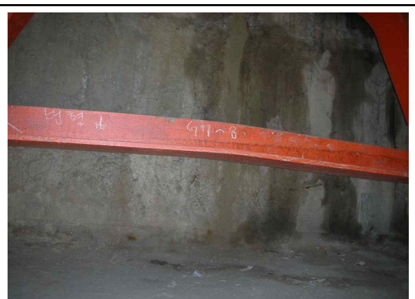
·위 치 : 주형 및 가로보(Steel Plate Girder) ·현 황 : 가로보 변형 ·대 책 : 주의관찰
