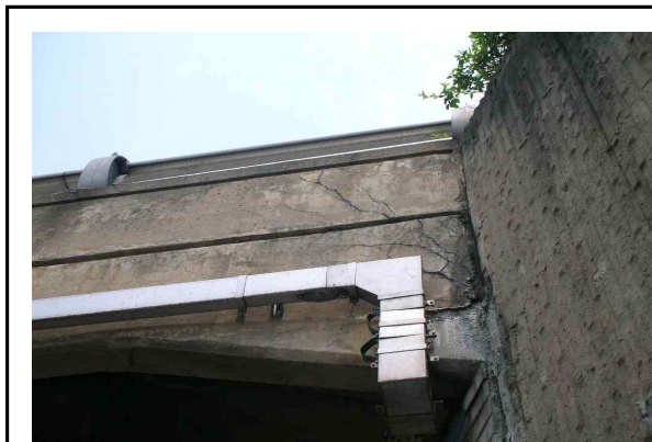
진출입부 벽체 균열
