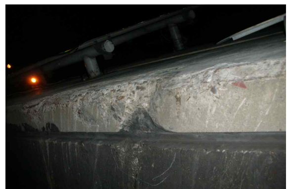
진출입부 콘크리트 파손
