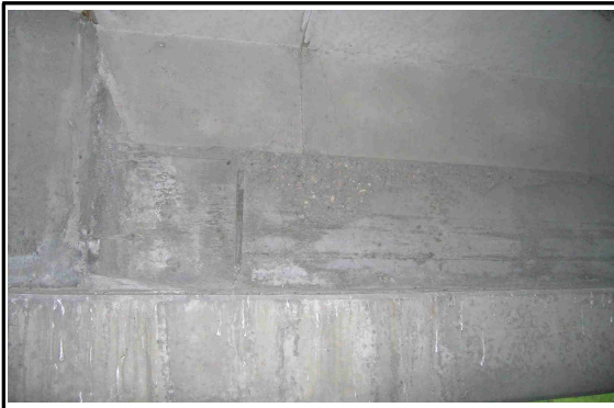
【사진 I.2.5】 거더 균열
