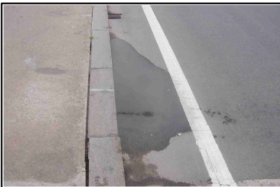
【사진 I .2.1】 교면포장부 체수
