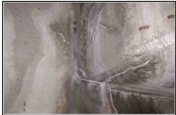
【사진 I.2.6】 가로부 균열 및 백태
