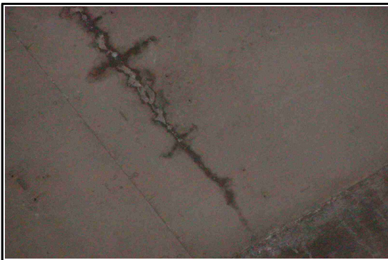
【사진 I .2.3】 슬래브 하면 백태
