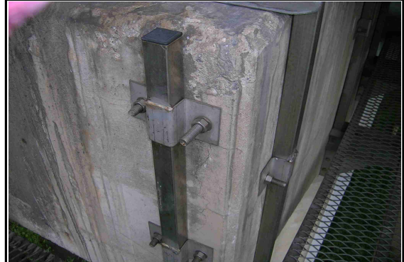
【사진 I.2.8】 교각 파손
