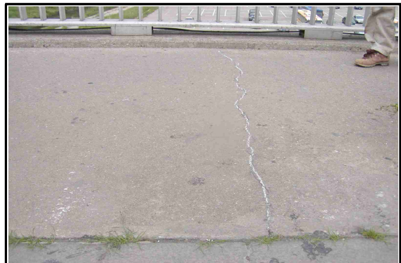
【사진 I .2.2】 보도 균열
