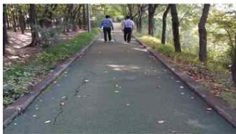
▲ 탄성포장 및 기초균열
