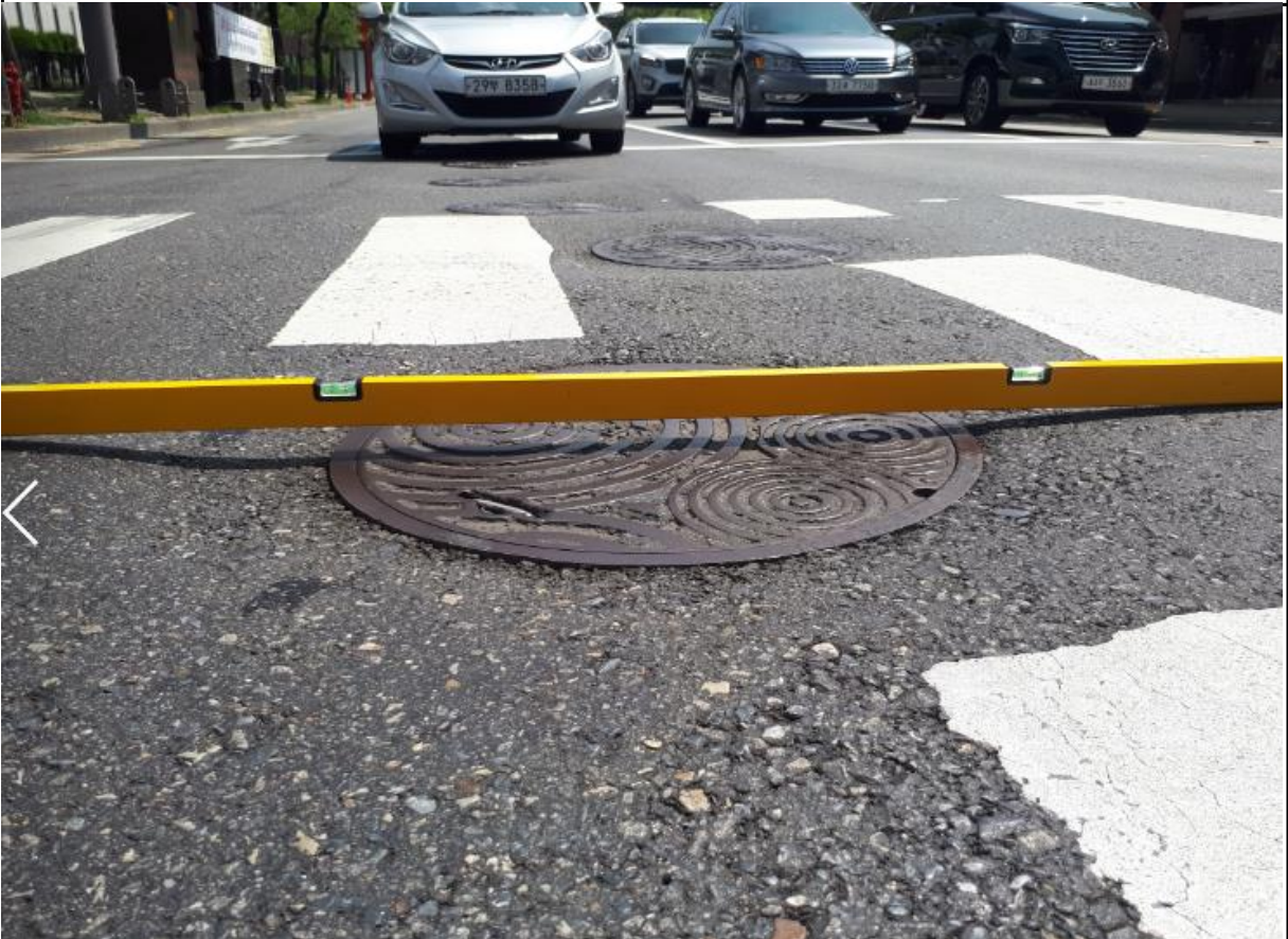
압구정로11길앞 교차로 횡단보도내 상수맨홀과 포장면 단차 발생
