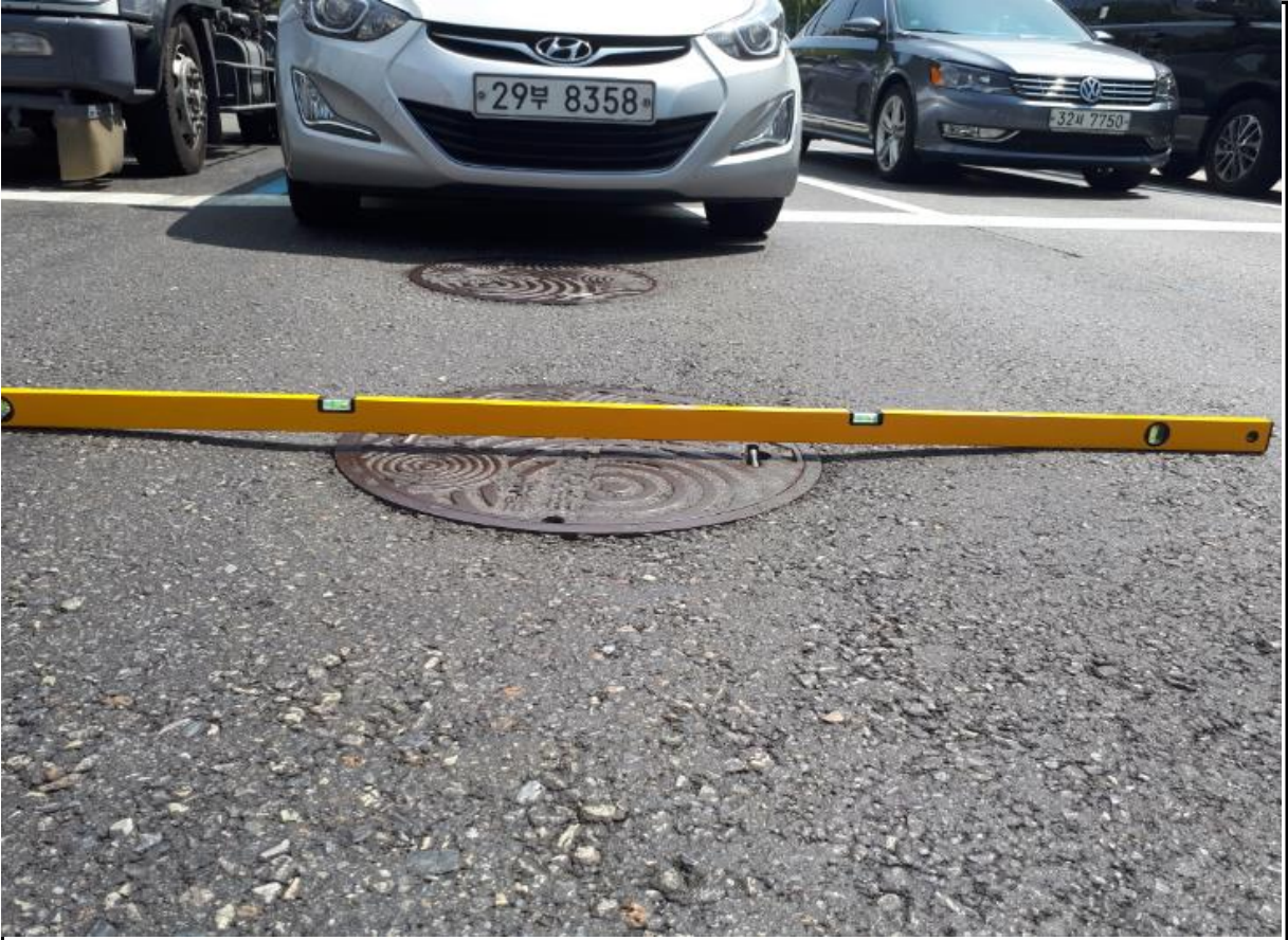
압구정로11길앞 교차로 횡단보도 5m 전 상수맨홀과 포장면 단차 발생
