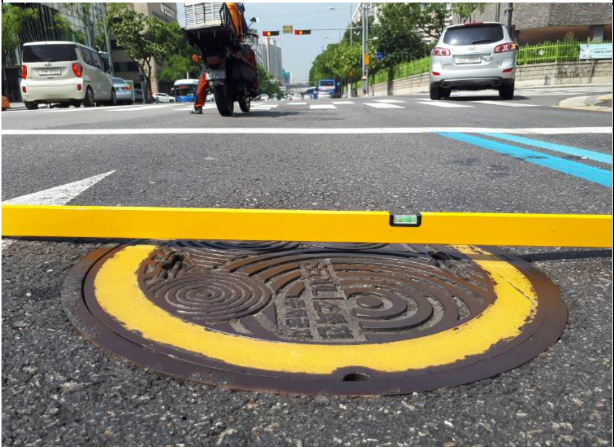
압구정로11길앞 교차로 횡단보도 10m 전 소화전맨홀과 포장면 단차 발생
