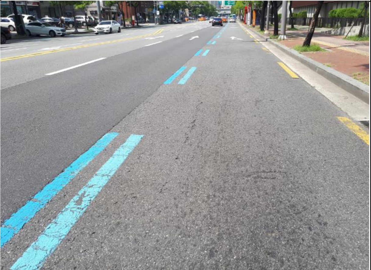
추가 정비요청 구간내 포장면 균열
