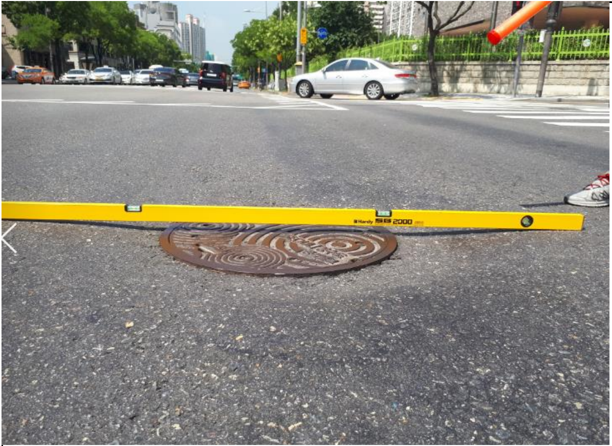
압구정로11길앞 교차로 횡단보도 통과 후 5m지점 상수맨홀과 포장면 단차 발생
