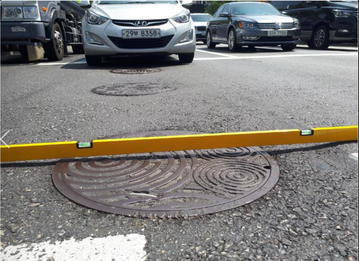
압구정로11길앞 교차로 횡단보도 직전 상수맨홀과 포장면 단차 발생
