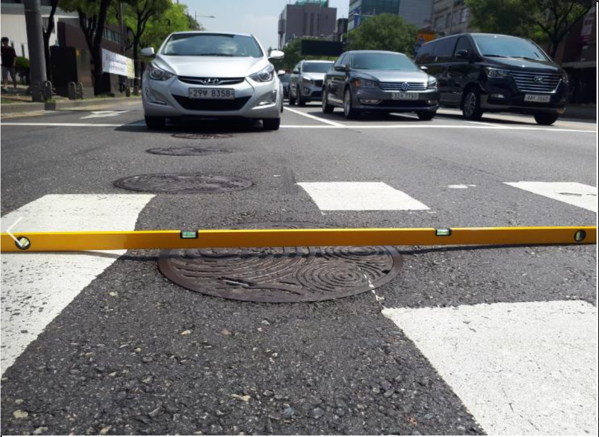
압구정로11길앞 교차로 횡단보도내 상수맨홀과 포장면 단차 발생
