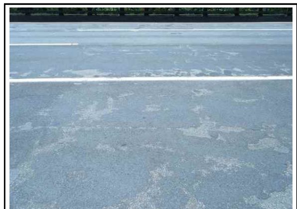
전면식 미끄럼방지포장 탈락(S1-4차선)
