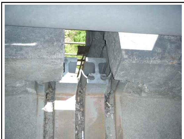
방호벽 차수강판 탈락(P3)
