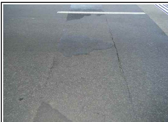
이격식 미끄럼방지포장 탈락(S3-4차선)
