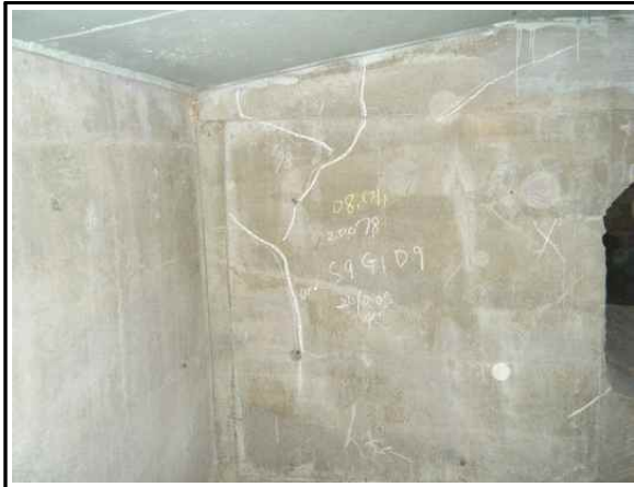
격벽의 불규칙 균열(S9-G1-D9(P9지점))
