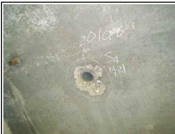
배수구 주변 박리 및 파손(S4-LF)
