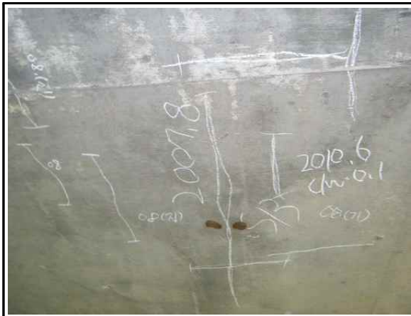
하부플랜지 횡·종방향 균열(S3-LF)
