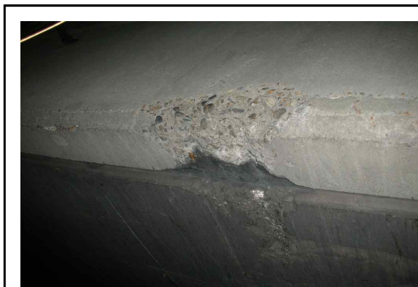
진출입부 콘크리트 파손
