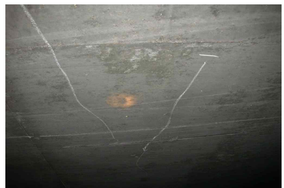
슬래브 하면 균열(0.3mm 미만)
