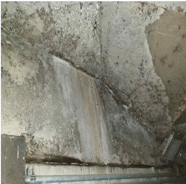
슬래브 하면 백태
