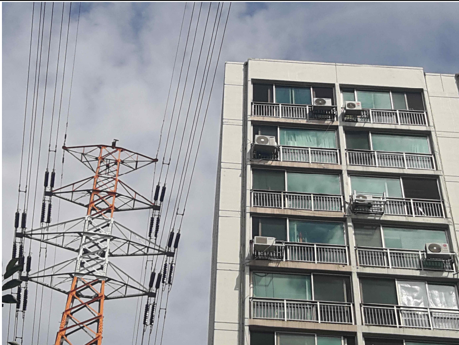
사슴아파트3단지 내 철탑 - 애자파손 추락시 위험
