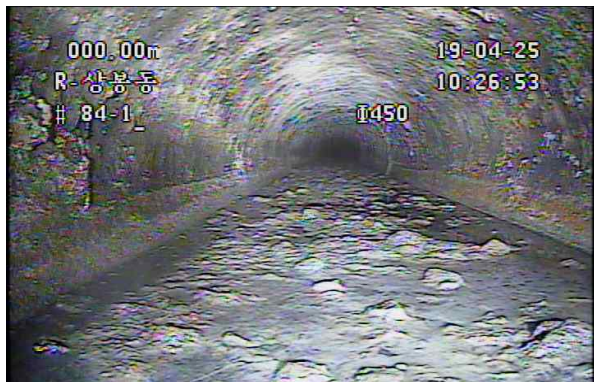
관로 상단부 파손
