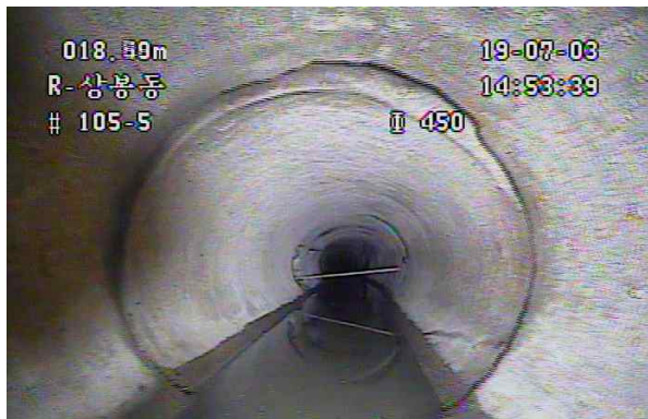
이음부 단차 및 파손
