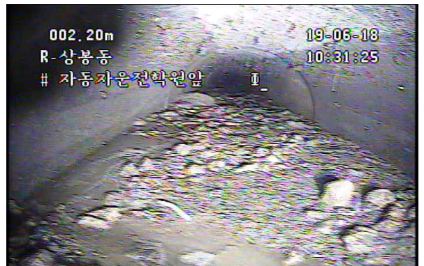
하수관로 노후화로 인한 파손
