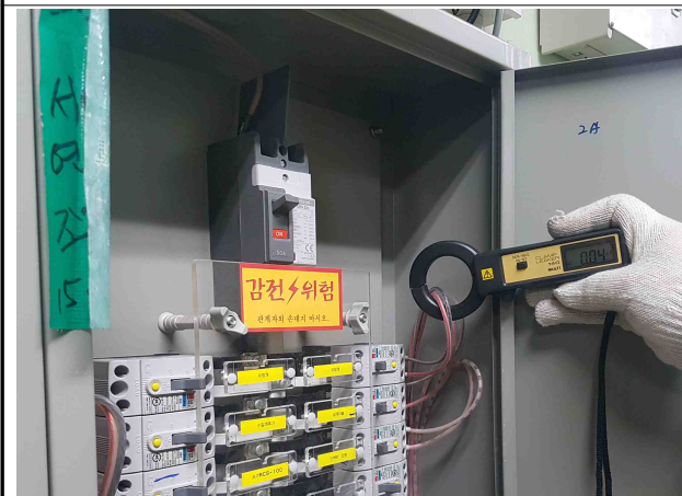
< 누설전류 측정 사진 >
