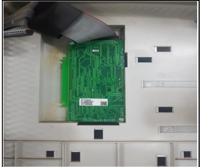
내용 C-PCB 교체 후
