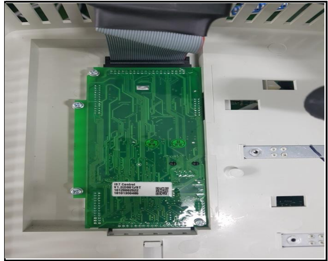
내용 C-PCB 교체 후
