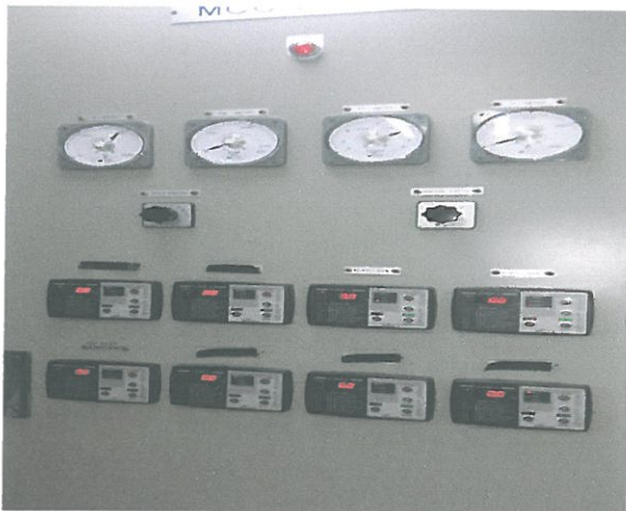
인버터 제어반 점검
