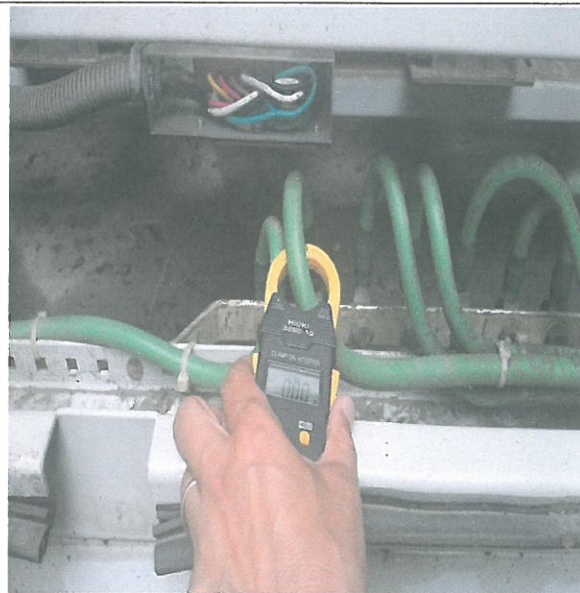
종합 접지단자함 누설전류 측정
