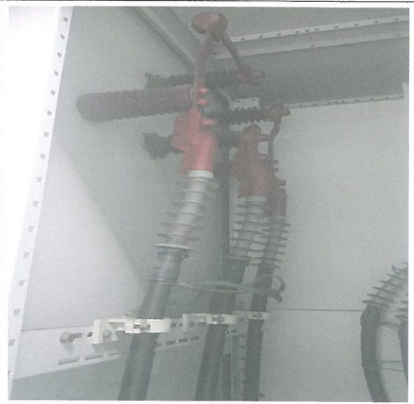
특고압 헤드 적외선 열온도 측정
