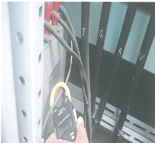
저압 콘덴서 점검 및 누설전류 측정
