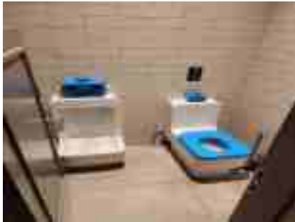
아동 변기 설치 사례 (A백화점 가족화장실)
