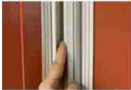
손 끼임 방지장치가 설치된 출입문 (자료: 장미현 외, 2021: 82)
