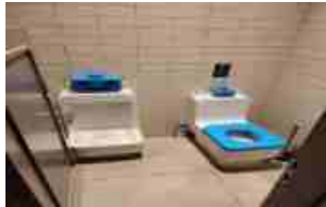
아동용변기와 소변기를 각각 설치 (A 백화점 가족화장실)
