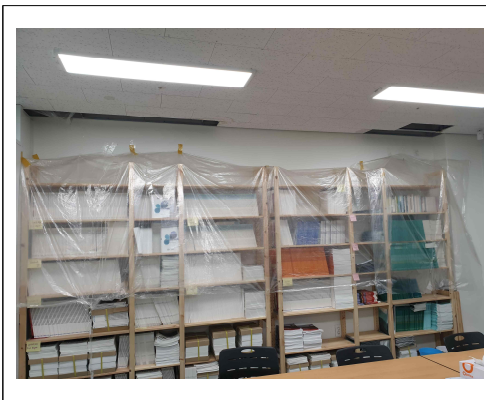
·회의실 천장 누수로 인해 비닐로 덮어둔 책꽂이
