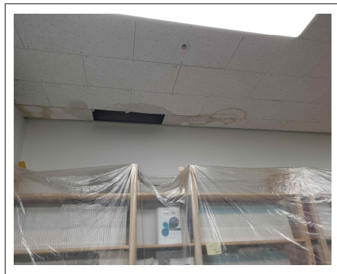
·회의실 천장 누수로 인한 텍스타일 천공
