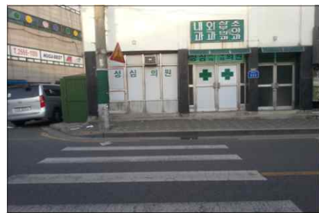
▲ 횡단보도 턱낮춤 및 점자블록 미설치
