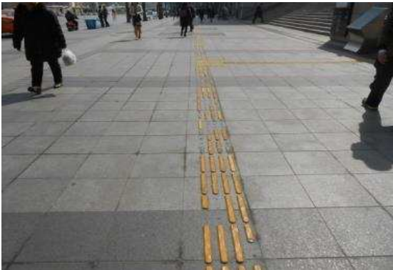
▲ 비규격 점자블록 탈락 (정비 전)
