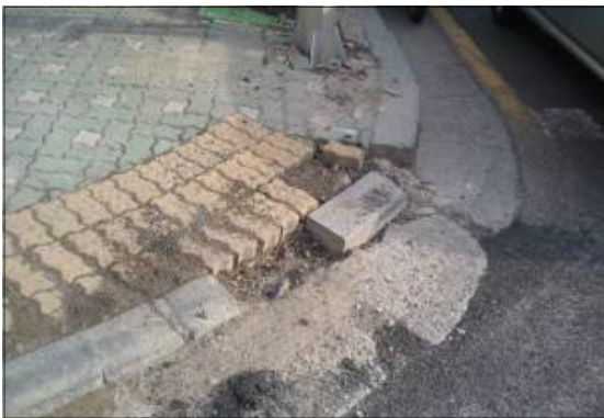
▲ 점자블록 파손 (정비 전)
