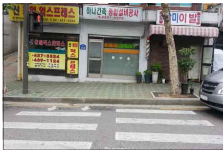
▲ 횡단보도 턱낮춤 및 점자블록 미설치
