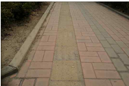
▲ 노후 및 파손
