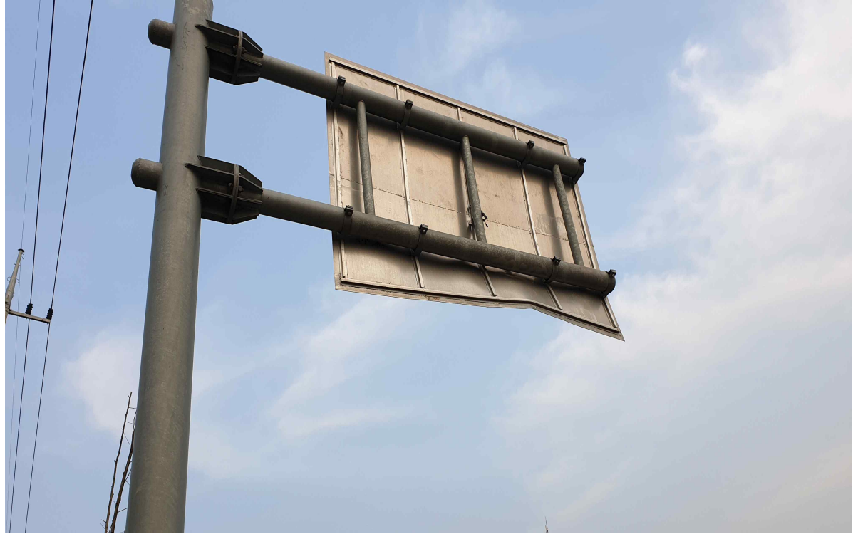
대형표지판 노후 및 파손[2018.11.06.현장]
