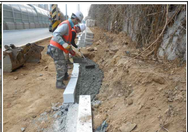
▲ 경계석 기초콘크리트 거푸집 설치 미흡
