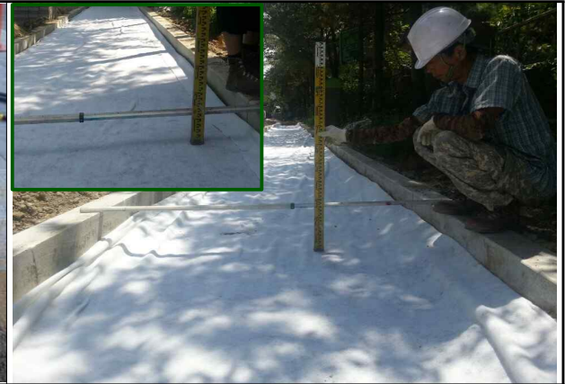
적정 : 투수기층 상하부 토목부직포 설치
