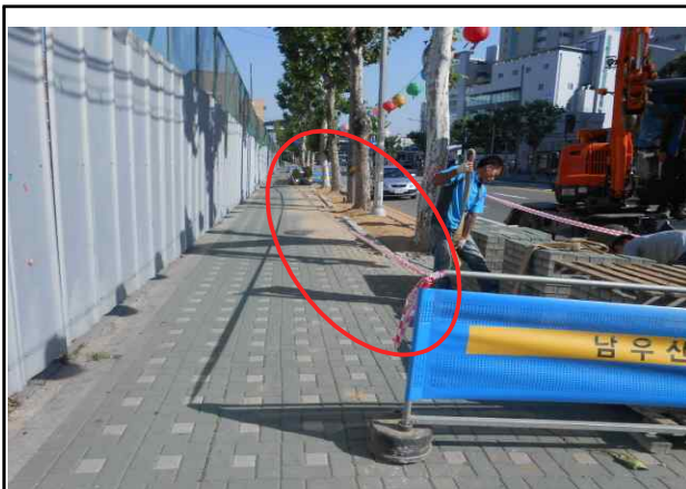
부적정 : 공사주변 안전펜스 설치 부적정
