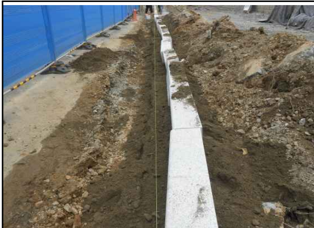
▲ 경계석 기초 거푸집 미설치 시공
