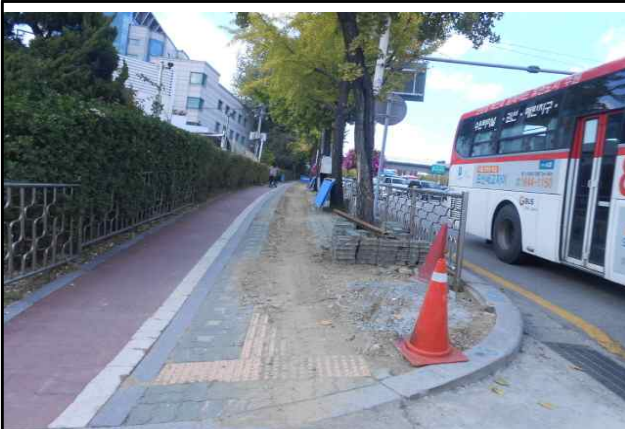
▲ 안전펜스 미설치 및 임시보행로 미확보
