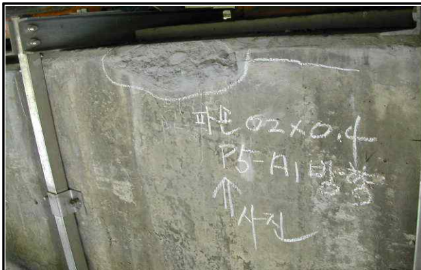
교각 코핑부 파손 (구교)
