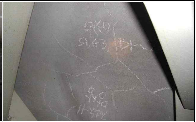
슬래브 하면 망상균열 (신교)
