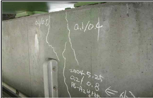
교각코핑부 수직 균열 (신교)
