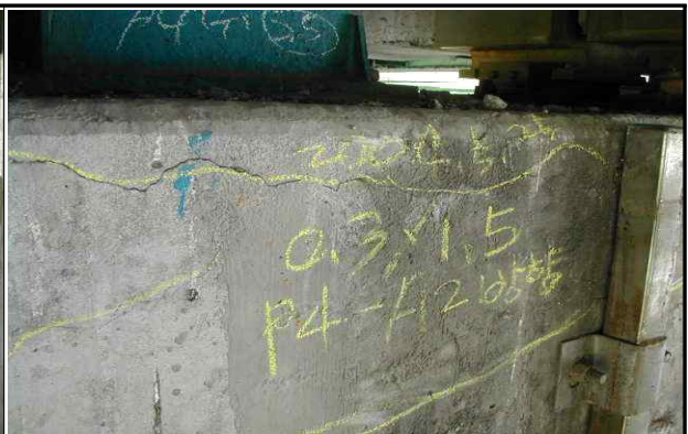
교각 코핑부 수평균열 (구교)
