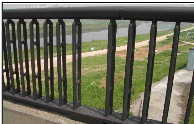
인도부 난간 파손
