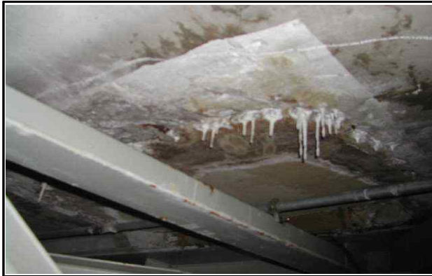
슬래브 하면 누수 및 백태 (신교)
