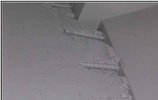
슬래브 하면 철근노출 (구교)
