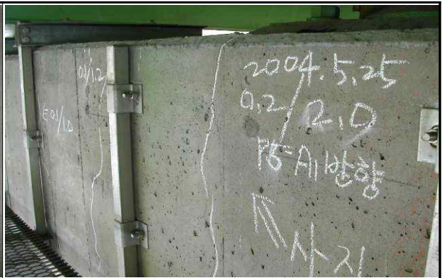
교각코핑부 수직 균열 (신교)
