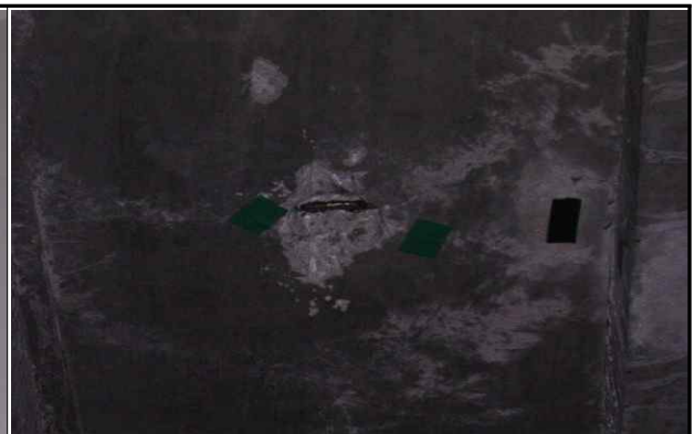
슬래브 하면 철근노출 (구교)
