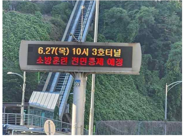
도로전광표지판(남산3호터널 요금소 앞)
