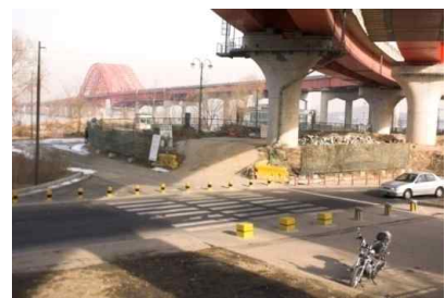
4) 대상지 진입구 공사자재물과 시설등의 혼잡
