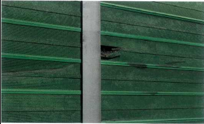
알루미늄 방음판 파손
