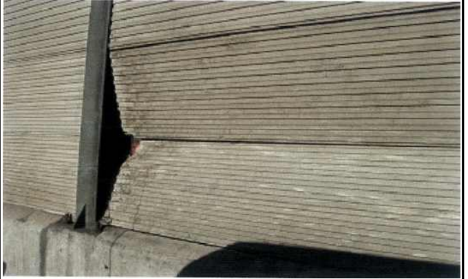
콘크리트 방음판 파손
