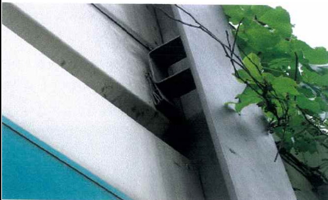
스프링클립 탈락 위험
