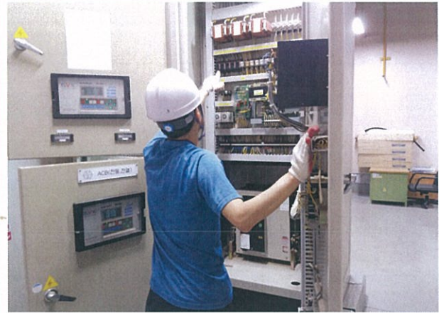
발전기 제어반 점검(양호)
