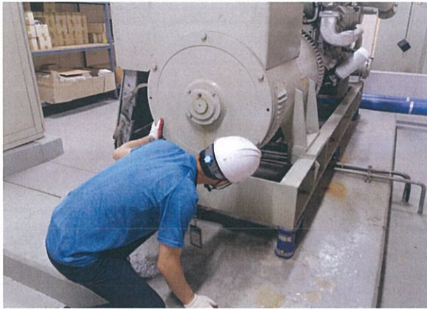
발전기 외관 점검(양호)
