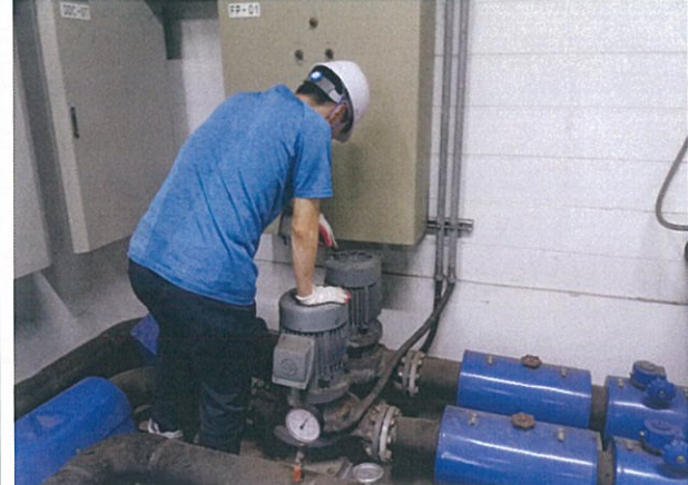
냉각수 펌프 동작상태 점검(양호)
