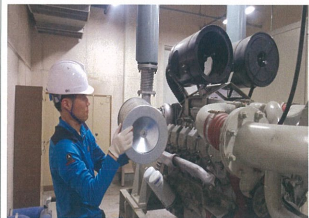
발전기 에어필터 점검(양호)
