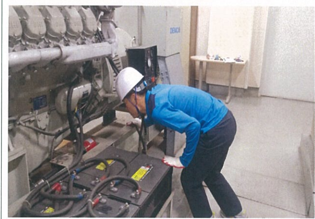
발전기 외관 점검(양호)
