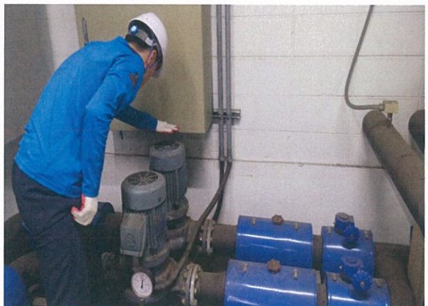
냉각수 펌프 동작상태 점검(양호)
