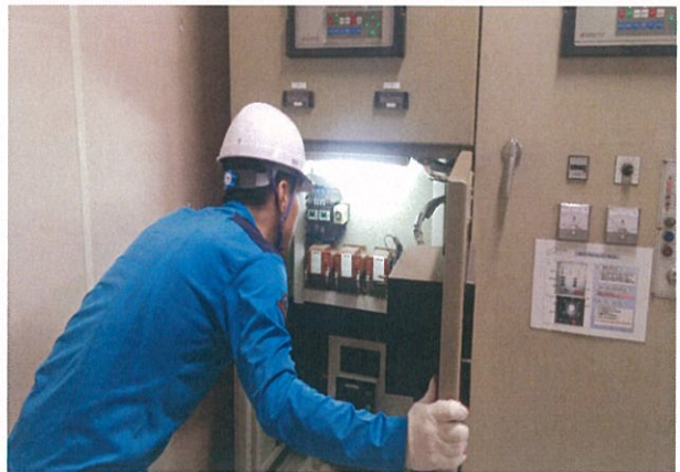
발전기 제어반 점검(양호)
