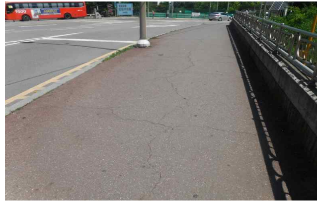
보도부 포장 망상균열
